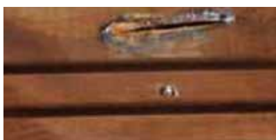
Remontées de résine
